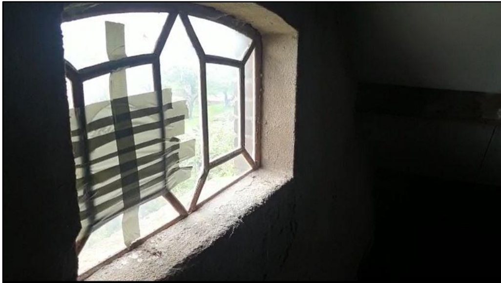
Figuur 4 De kapotte ramen in de schuur op de planlocatie zijn gerepareerd waardoor de bebouwing niet toegankelijk is voor uilen.
